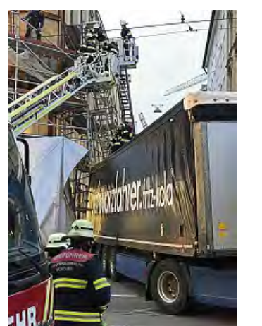
Der Cola-Laster hatte das Gerüst touchiert.
